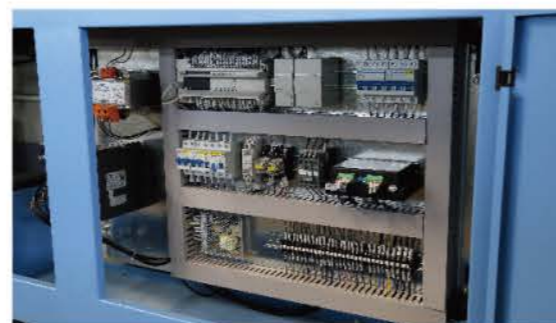
▲ 整经电气控制系统 Warping electrical control system
